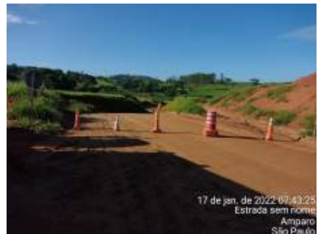
Foto 208 – Sinalização de interdição de acesso interno da Obra. (Data: 17/01/2021)
