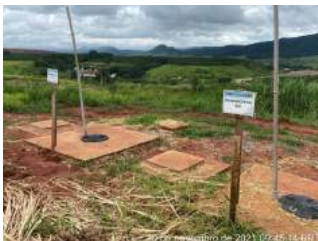
Foto 330 – Biodigestores do canteiro industrial . (Data: 30/11/2021)
