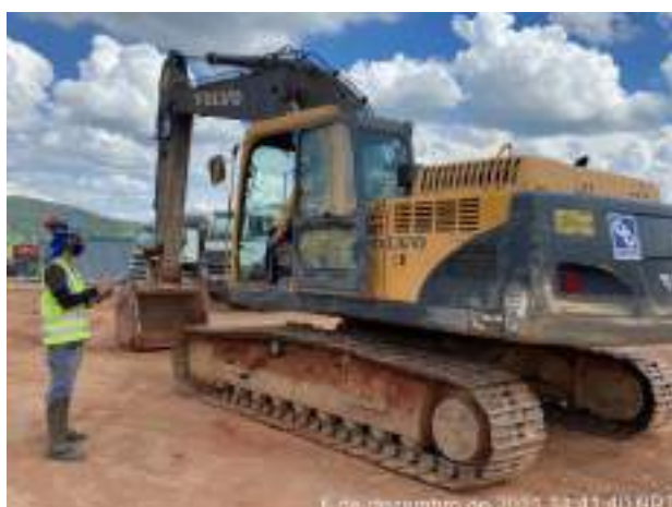
Foto 147 – Check list equipamento. (Data:06/12/2021)
