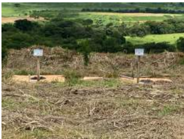
Foto 336 – Biodigestores do canteiro Industrial. (Data: 28/01/2022)
