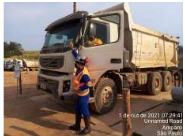
Foto 144 – Check list equipamento. (Data: 01/10/2021)
