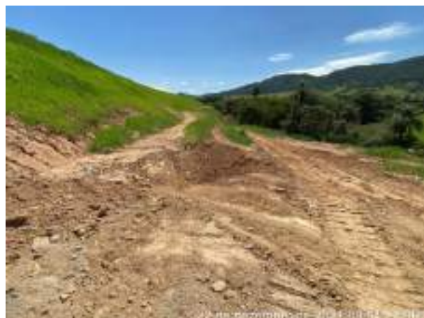
Foto 252 – Destaque para cacimbas de retenção de sedimentos. (Data: 22/12/2021)
