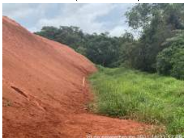
Foto 221 – Canaleta e leira de proteção no entorno do bota espera com inclinação para a saia do talude. (Data:30/11/2021)
