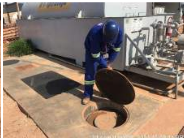
Foto 317 – Vistoria - Caixa SAO do tanque de combustível. (Data: 21/10/2021)
