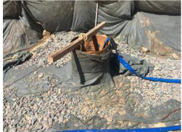
Foto 140 – Dreno feito de tambor. (Data:20/11/2021)
