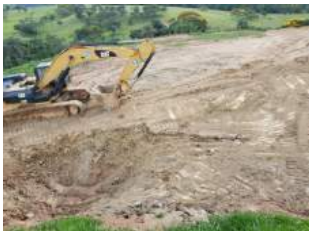
Foto 251 – Destaque para cacimbas de retenção de sedimentos. (Data: 22/12/2021)
