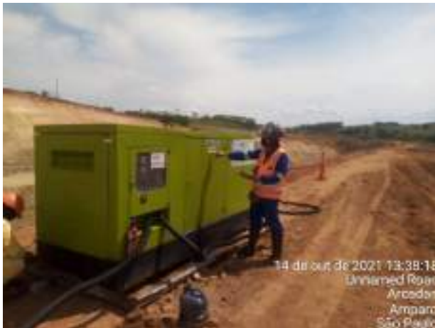
Foto 143 – Check list equipamento. (Data:14/10/2021)
