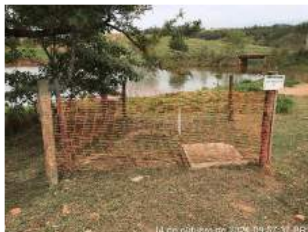
Foto 327 – Biodigestores do canteiro industrial. (Data: 14/10/2021)
