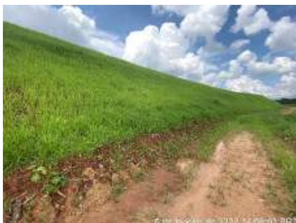
Foto 253 – Cobertura vegetal, leira e canaletão para retenção de material e disciplinamento do fluxo para as caixas de retenção. Bota Fora 01
