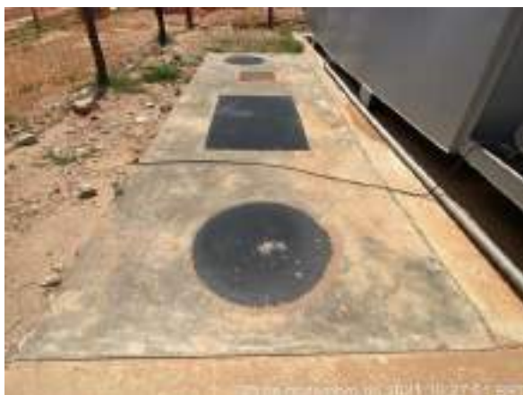
Foto 320 – Monitoramento da Caixa SAO do tanque de combustível. (Data: 20/12/2021)
