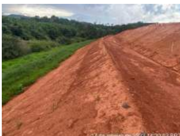
Foto 228 – Canaleta e leira de proteção no entorno do bota espera com inclinação para a saída do talude. (Data: 17/01/2022)
