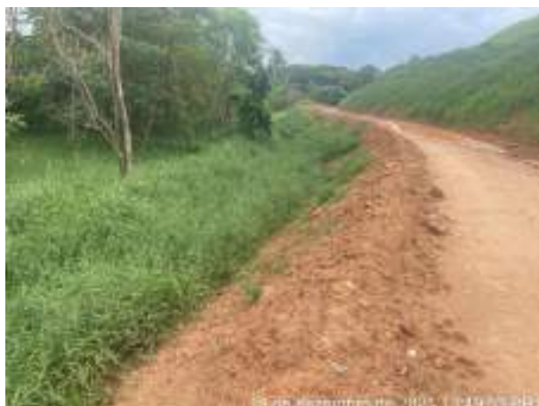
Foto 247 – Leira para retenção de material e disciplinamento do fluxo para as caixas de retenção. Bota Fora 01 (Data: 13/12/2021)
