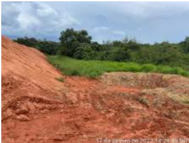
Foto 232 – Cacimba de retenção de sedimento. (Data:17/01/2022)
