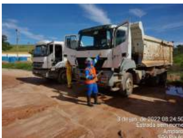
Foto 149 – Check list equipamento. (Data:03/01/2022)
