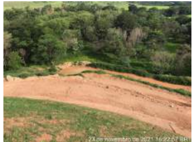
Foto 246 – Destaque para cacimbas de retenção de sedimentos. (Data: 23/11/2021)
