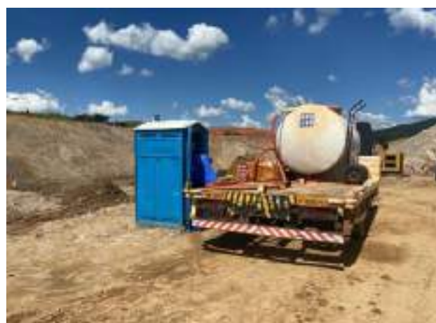
Foto 329 – Limpeza do banheiro químico. (Data: 29/11/2021)
