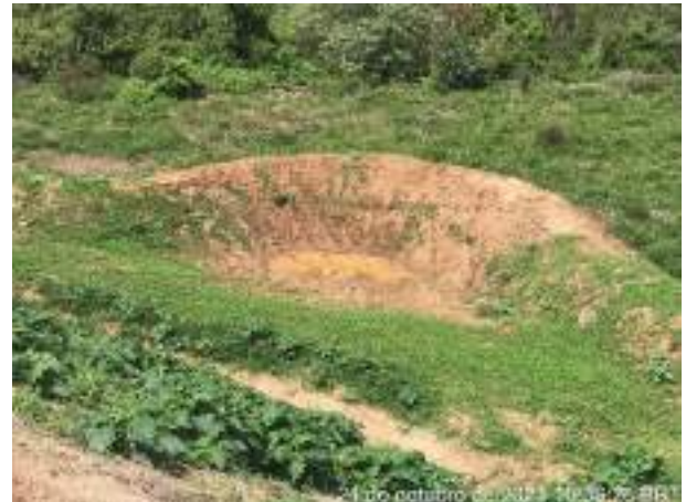
Foto 265 – Vista para a cacimba de retenção de sólidos com vegetação estabelecida na borda. (Data: 21/10/2021)
