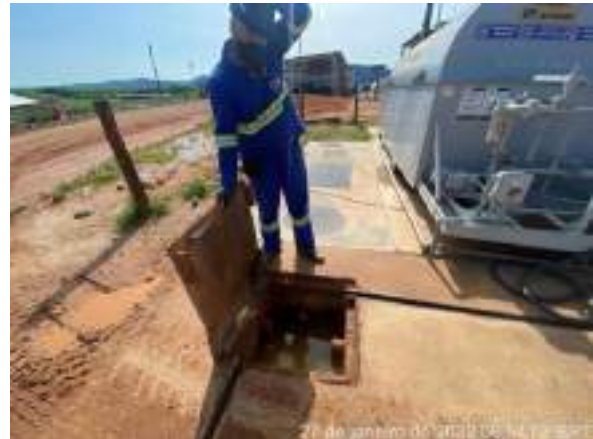
Foto 323 – Vistoria - Caixa SAO do tanque de combustível. (Data: 27/01/2022)
