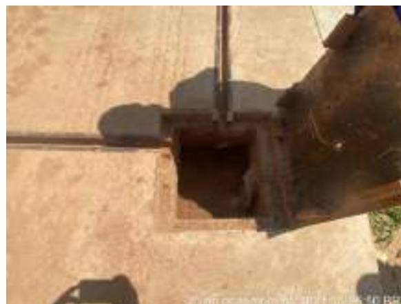
Foto 321 – Vistoria - Caixa SAO do tanque de combustível. (Data: 20/12/2021)
