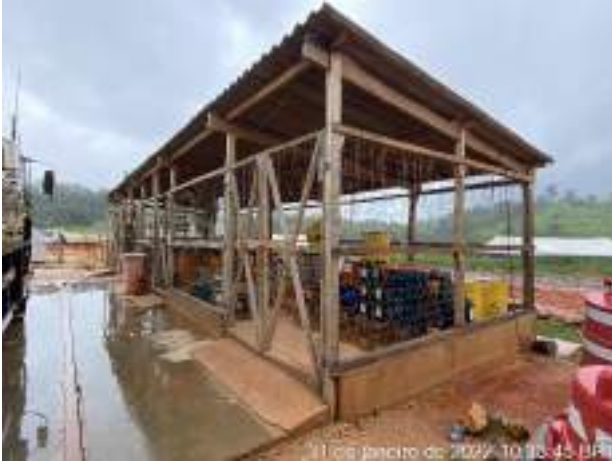
Foto 83 – Baia para armazenamento de produto químico. (Data:31/01/2022)
