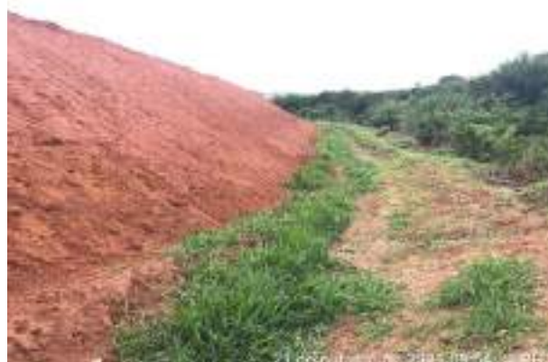
Foto 225 – Canaleta e leira de proteção no entorno do bota espera com inclinação para a saída do talude. (Data:21/10/2021)
