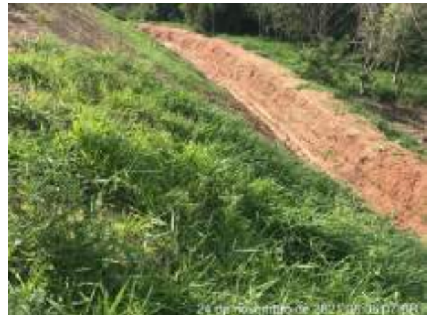
Foto 244 – Leira e canaletão para retenção de material e disciplinamento do fluxo para as caixas de retenção. (Data:24/11/2021)
