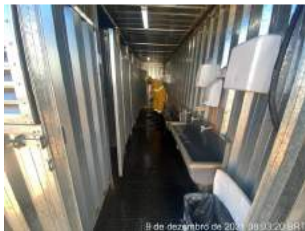
Foto 110 – Limpeza do sanitário no canteiro industrial. (Data:09/12/2021)
