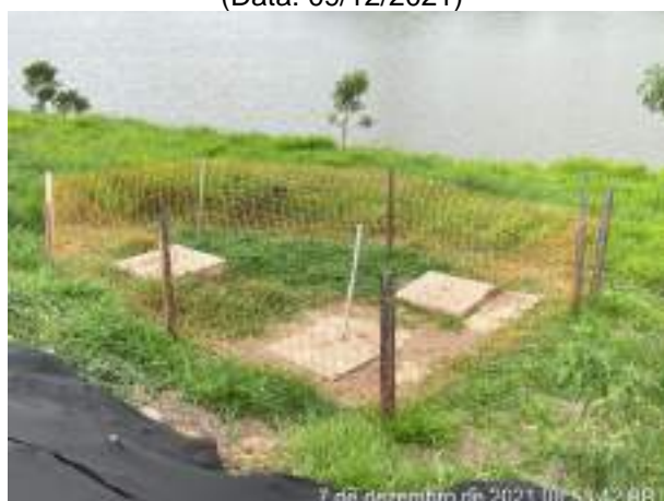
Foto 334 – Biodigestores do canteiro Administrativo. (Data: 07/12/2021)
