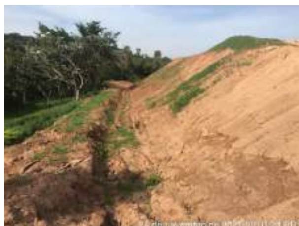
Foto 242 – Leira e canaletão para retenção de material e disciplinamento do fluxo para as caixas de retenção. (Data: 24/11/2021)
