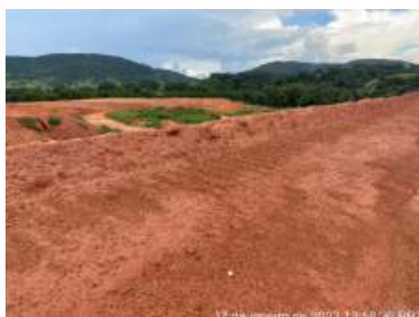
Foto 229 – Vista para inclinação e direcionamento do platô. Leira de solo entre as bermas do talude do bota espera (Data:17/01/2022)
