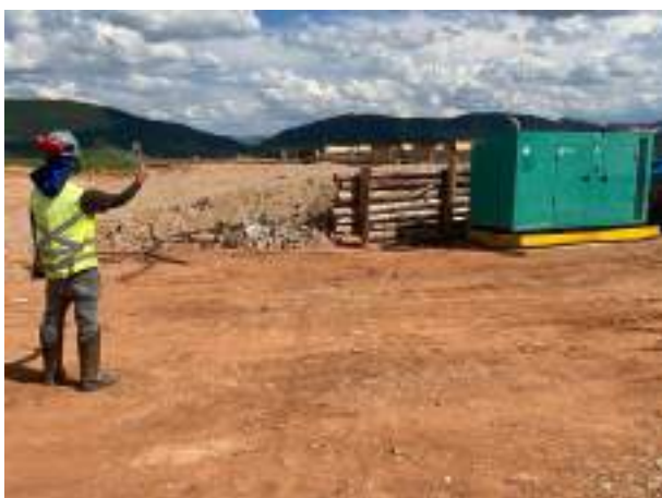
Foto 356 – Inspeção de fumaça preta do Gerador. (Data:30/11/2021)
