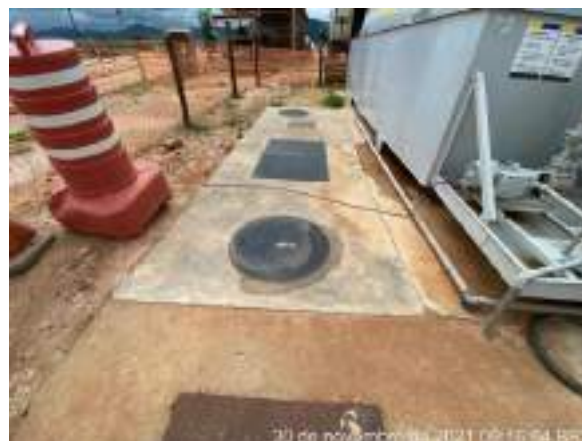
Foto 319 – Vistoria - Caixa SAO do tanque de combustível. (Data: 30/11/2021)
