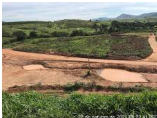
Foto 238 – Destaque para cacimbas de retenção de sedimentos. (Data:27/10/2021)
