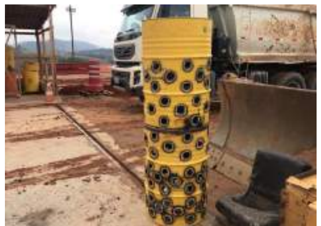
Foto 138 – Tambores soldados e com furos para dreno. (Data:20/10/2021)
