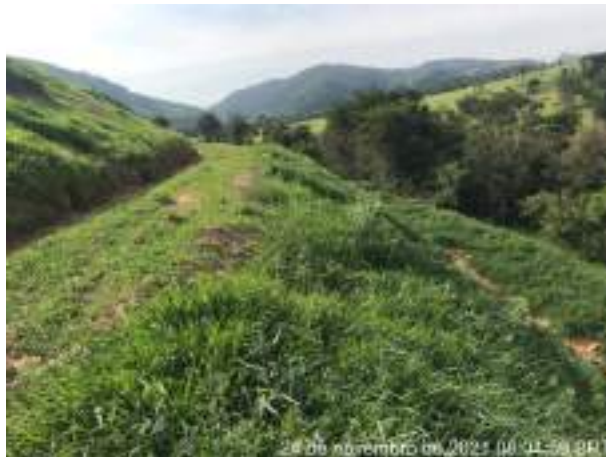
Foto 243 – Cobertura vegetal, leira e canaletão para retenção de material e disciplinamento do fluxo para as caixas de retenção. (Data:24/11/2021)
